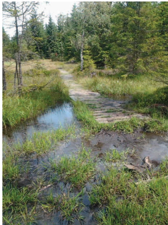
TURISTICKÁ INFRASTRUKTURA V JIZERSKÝCH HORÁCH VYŽADUJE NA NĚKTERÝCH MÍSTECH OBNOVU
